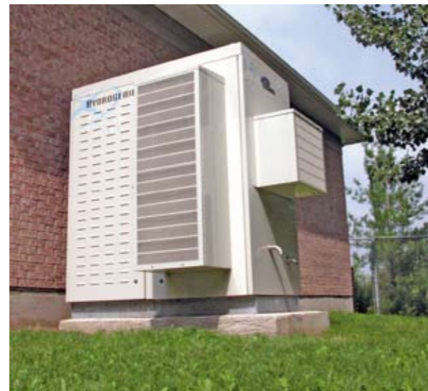
Sistema de Potência Back-up Bell Telecom
