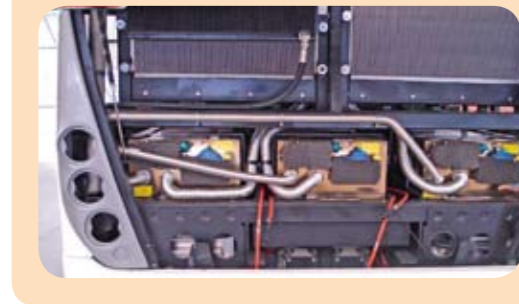
Instalação dos sistemas de ventilação e controle de temperatura das baterias de alta tensão.
